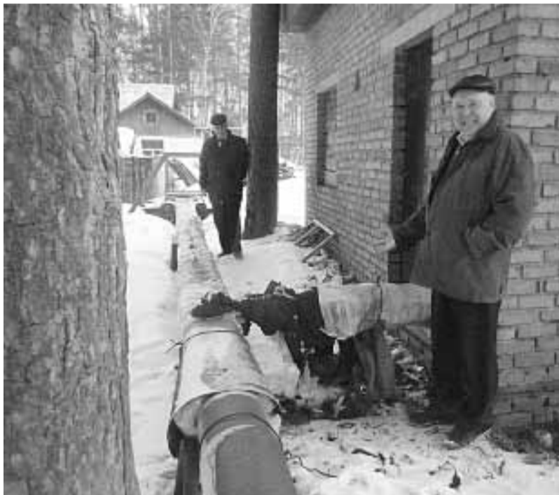
Виктор Иванович Ямщиков (на фото справа) демонстрирует качество ремонта на трубопроводе в Кедровом
